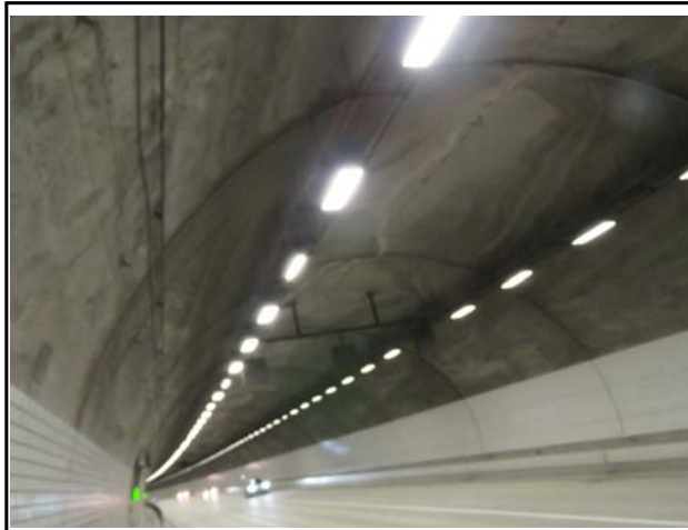
내 용 조명설비 전경
