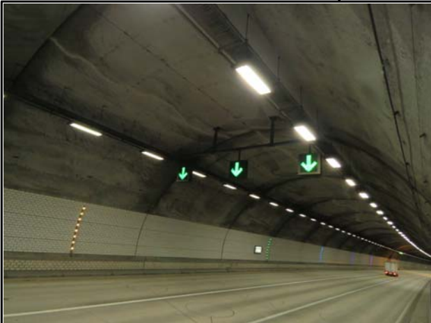
내 용 | 신호표시기 상태양호
