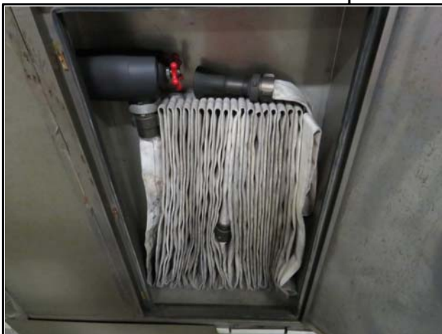
내 용 | 소화전 설치상태 양호
